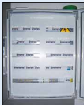
Foto N° 5: Sectorización de los Cuadros eléctricos.
