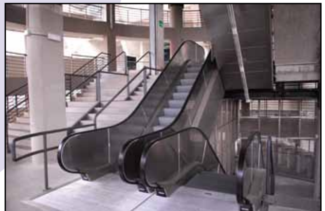
Foto N° 3: Escaleras Mecánicas (Estadio Santiago Bernabéu).
