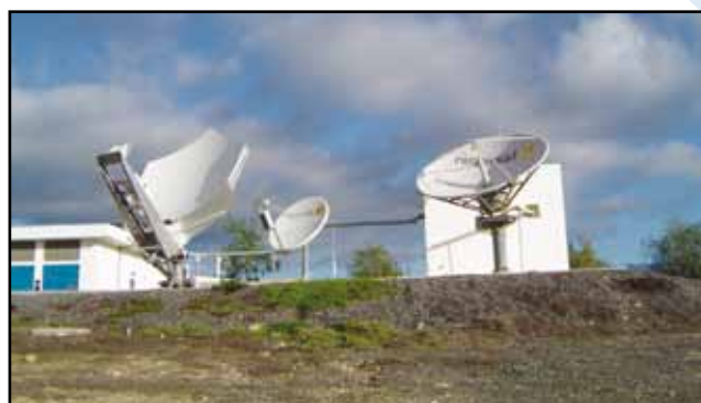
Foto N° 20: Conjunto de antenas del Proyecto Hispasat en el CEC.
