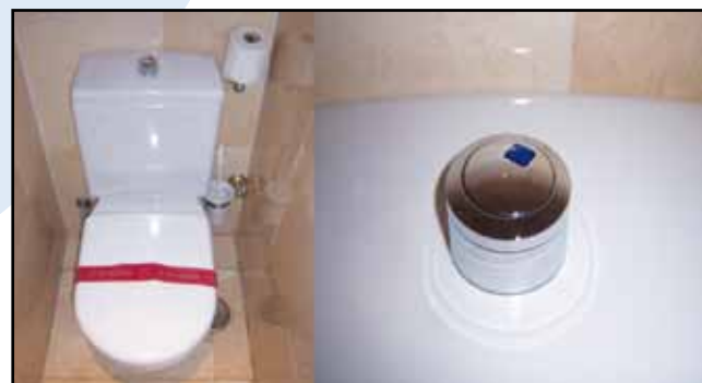
Foto N° 11: Cisterna de doble descarga baño cliente.
