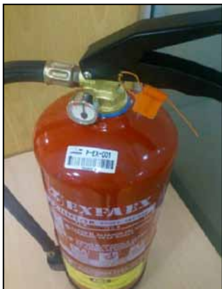
Foto N° 1: Ejemplo codificación extintor.
