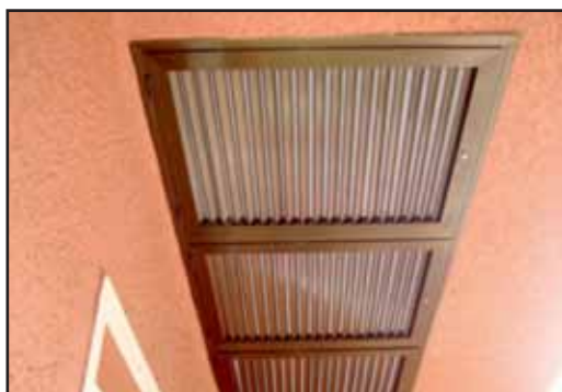
Foto N° 5: Rejillas de aspiración del sistema.
