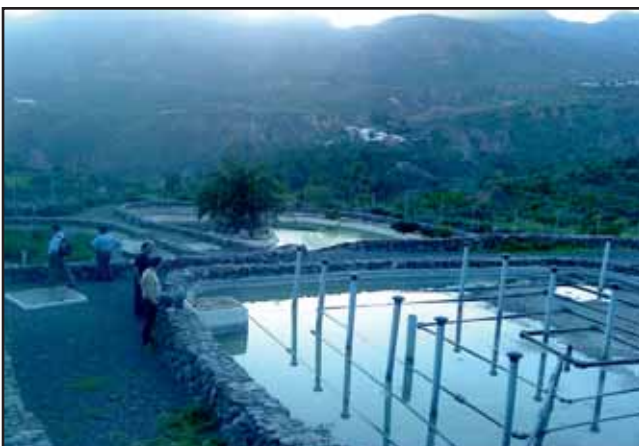
Foto N° 8: Depuradora Natural de Santa Lucía. Octubre 2011.
