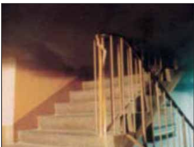
Foto N° 1: Escalera de evacuación con sistema de extracción de humos. ©MISTRAL®
