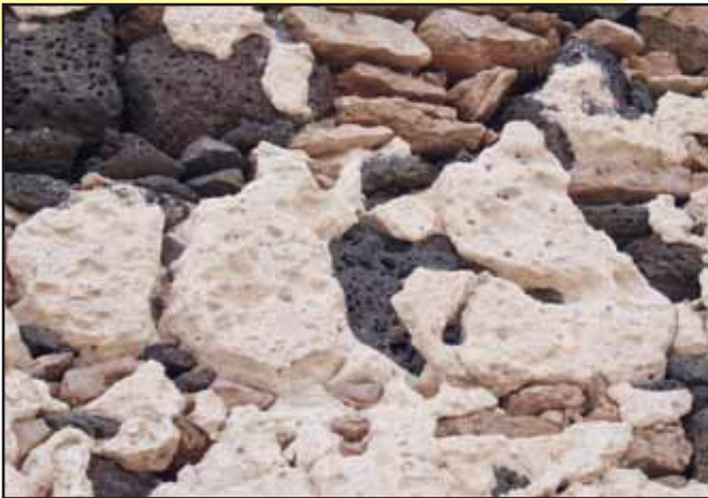
Foto N° 1: Restos de mortero de cal en un paramento. Fuerteventura, 2009.
