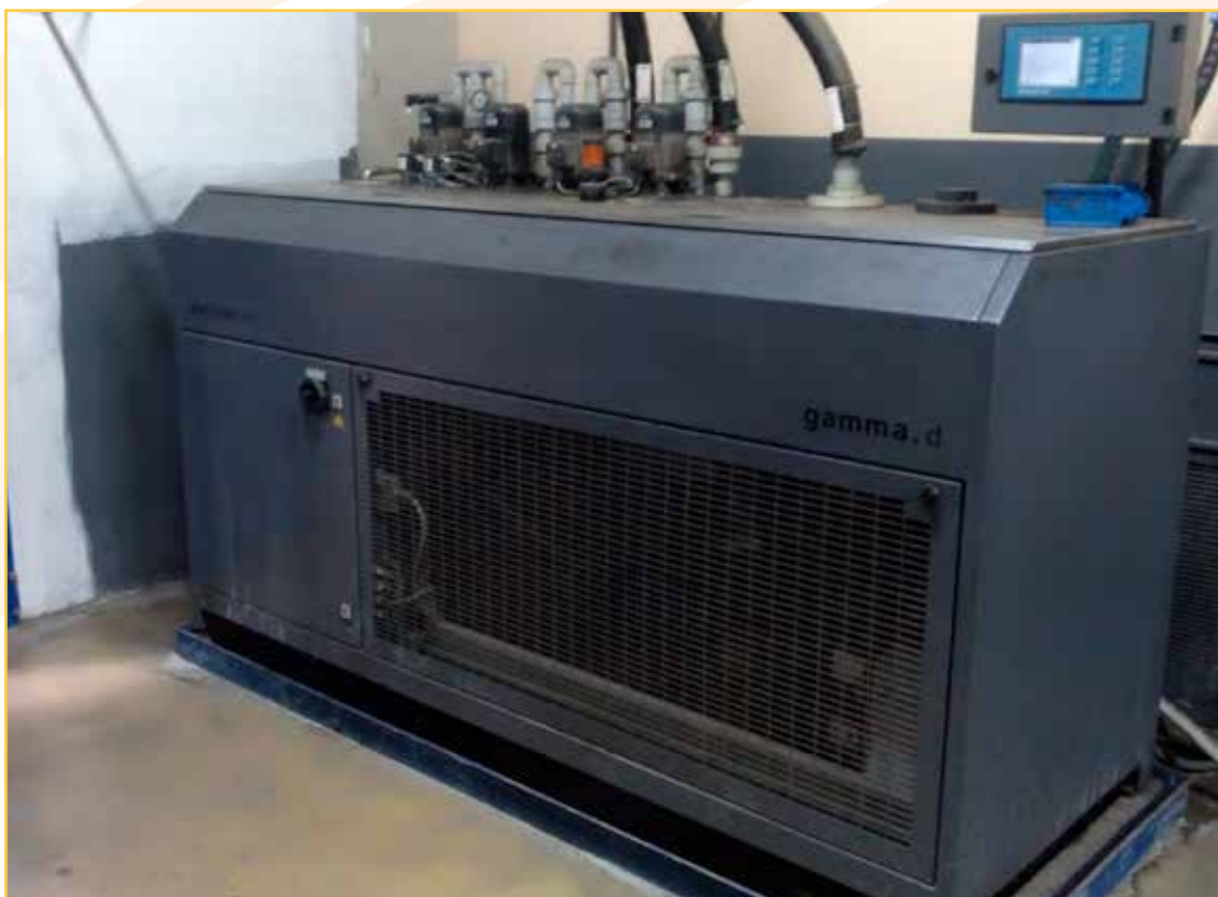
Foto N° 3: Enfriadora de agua Technotrans.
