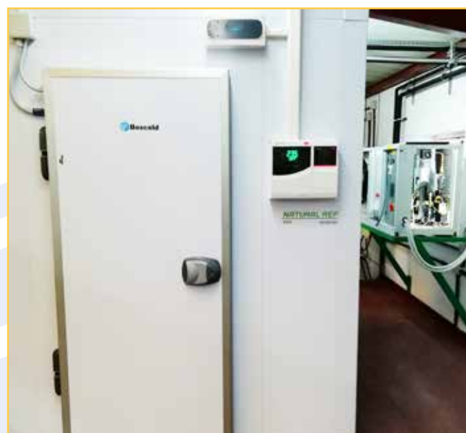
Foto Nº 1: Instalación equipo transcrito del IES Ingenio.
