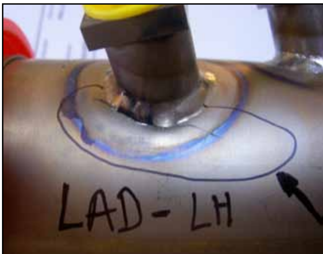
Figura 5: Marcado de la fuga.
