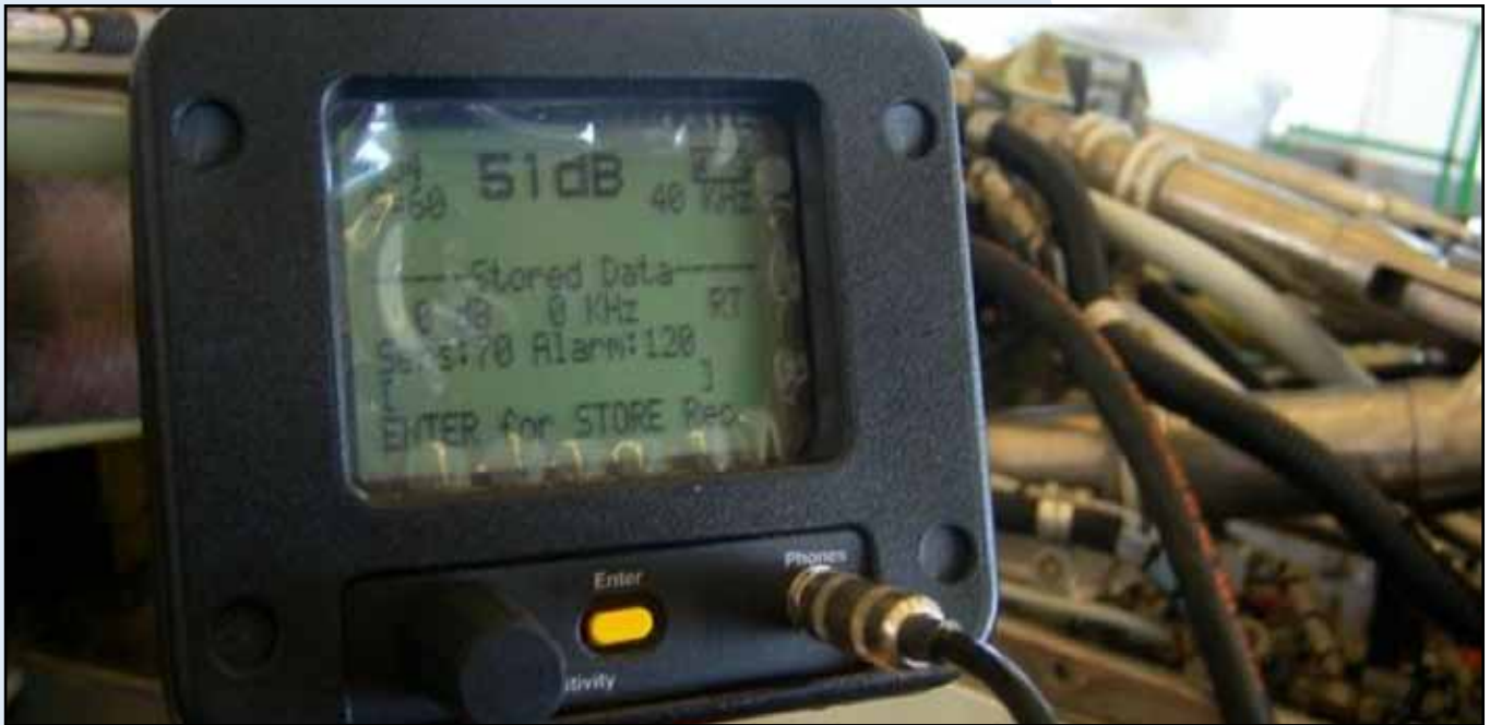
Figura 4: Localización y Cuantificación (51 DB) midiendo la severidad de la fuga de aire.
