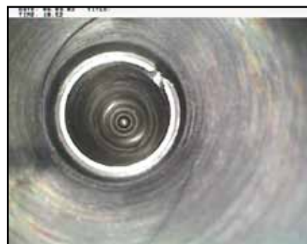
Taladro con fallo.
