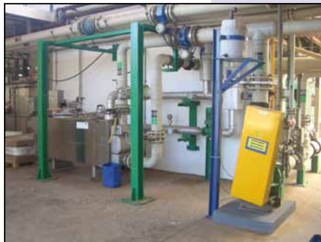
Foto N° 8: Equipos de recirculación del digestor.
