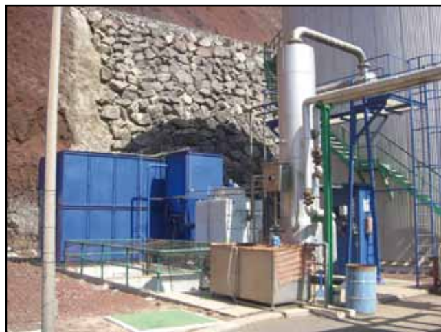
Foto N° 13: Depuradora de Lixiviados.
