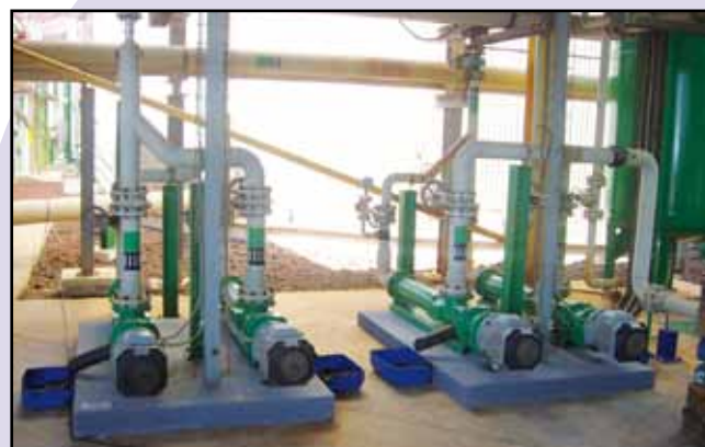
Foto N° 6: Equipos de carga y descarga del digestor.
