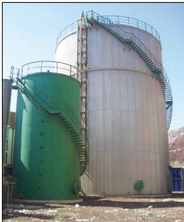
Foto N° 5: Tanque pulmón y digestor.
