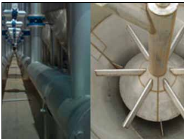
Foto N° 7: Proyecto Sistema de Filtración de Agua.
