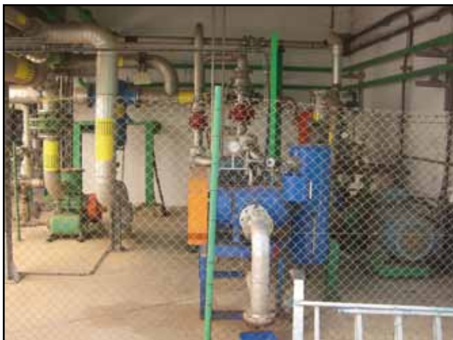
Foto N° 7: Compresor de Biogás.
