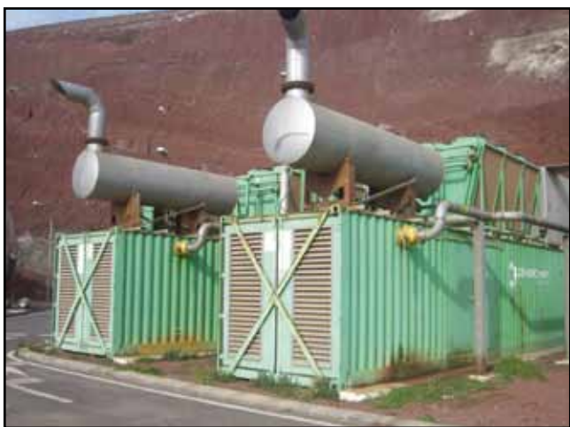
Foto N° 12: Motores de Cogeneración.
