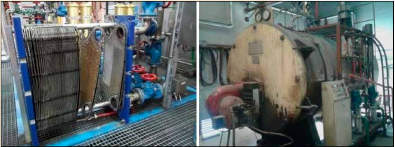
Foto N° 2: Foto de Intercambiador y Caldera.
